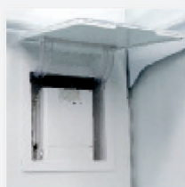
Система очистки воздуха.
